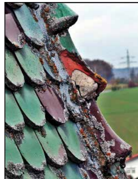
So sehen alle Grate am Kirchturmdach aus: Fugen, durch die Wasser eindringt, sind aufgebrochen. Bei etlichen Ziegeln fehlt ein Stück.
