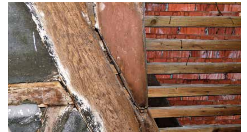
Dieser Dachbalken wird nur durch einen Stahlnagel gehalten und hat sich im Lauf der Jahrzehnte schon 2 cm vom Auflagepunkt wegbewegt.
