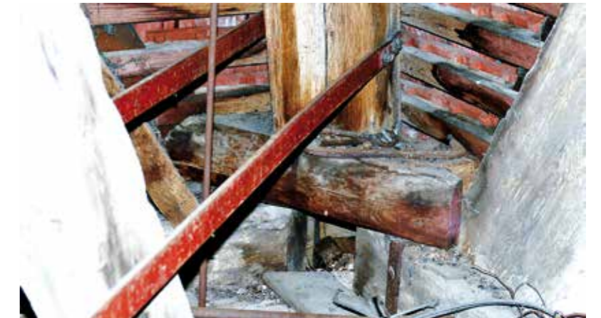
In dieser Ecke sind die Balken nur aufeinandergestellt, aber nicht fachwerkgemäß verbunden worden. Sie werden durch Metallbügel in Position gehalten.
