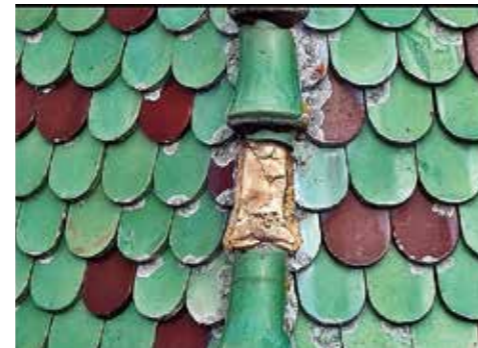
Ein Gratziegel des Kirchturms ist gebrochen und abgestürzt.
